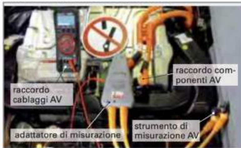
Figura 3: Impianto di misurazione per il controllo della resistenza di isolamento
